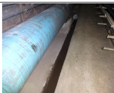
전력구 배수로 체수 (STA. 620m~640m)
