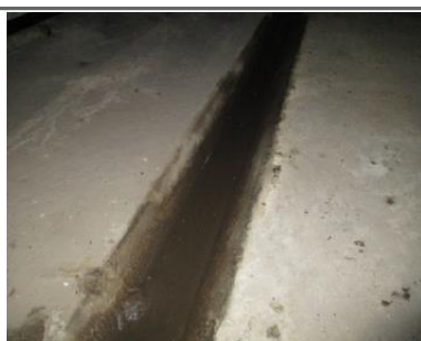
전력구 배수로 체수 (STA. 580m~600m)
