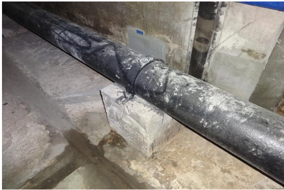
상수관 기초콘크리트 시공불량
