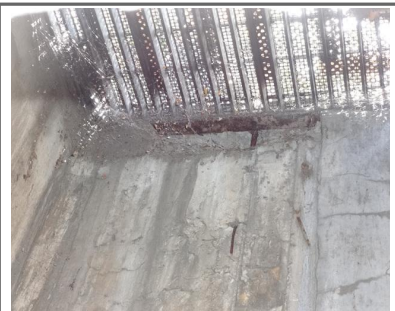
#4 콘크리트 걸침턱 박락
