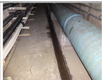
전력구 배수로 체수 (STA. 700m~720m)
